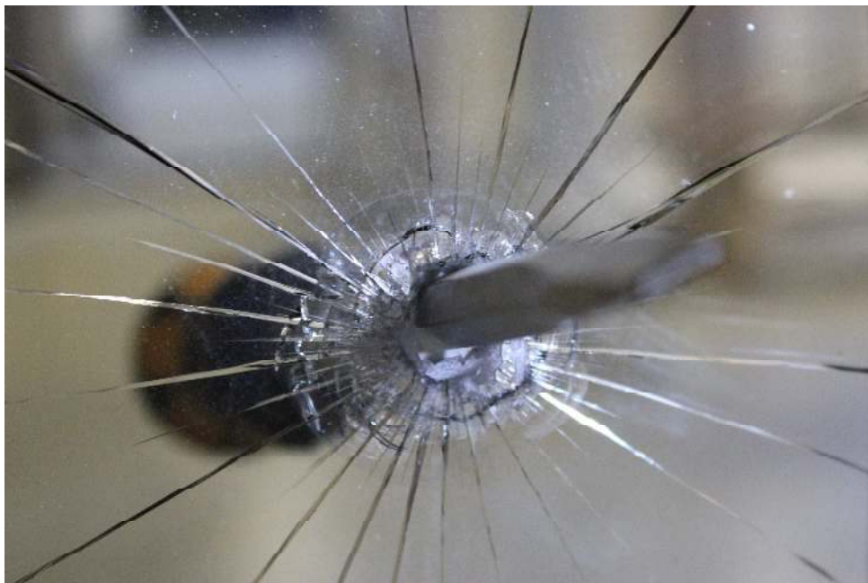
Bild 4 Schäden aus der manuellen Prüfung nach RC3
